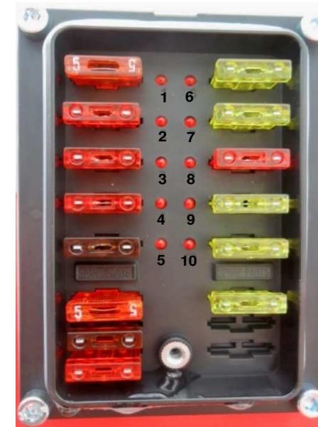
Figure 87 : boîtier de fusibles.
